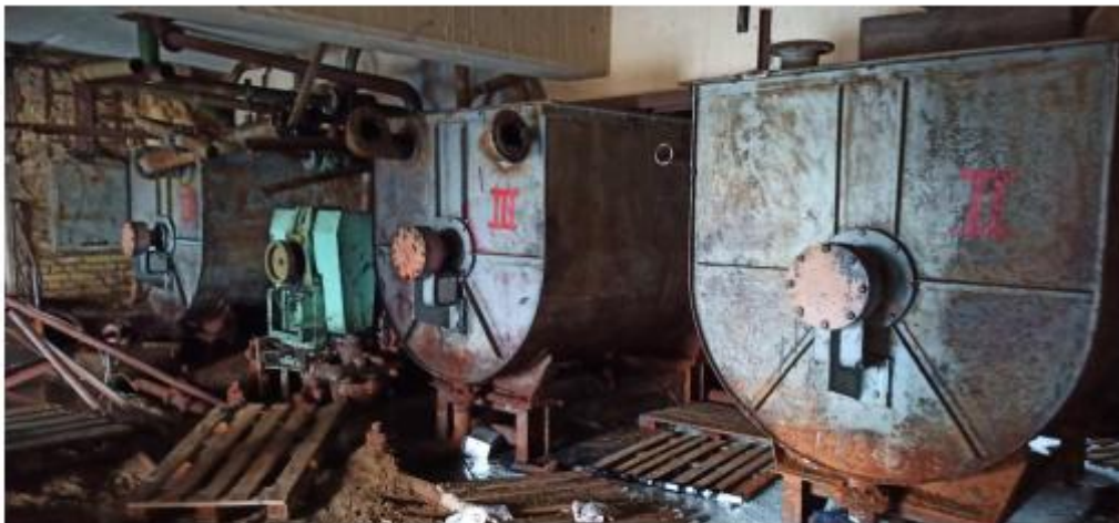
Bild 10: Blick in Keller des Mittelbaus (derzeit ca. 1 m unter Wasser)
