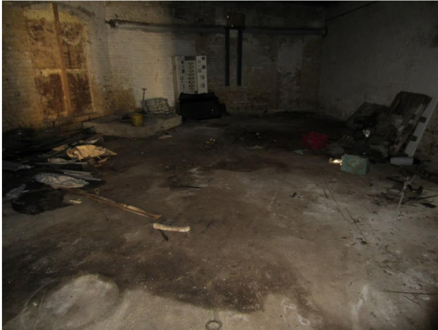
Bild 6: sichtbare Mineral-/Kompressorenöl-Einträge in der Bausubstanz, April 2019
